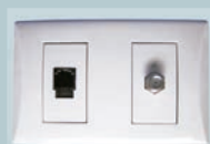
1007 A Toma TV / Teléfono
